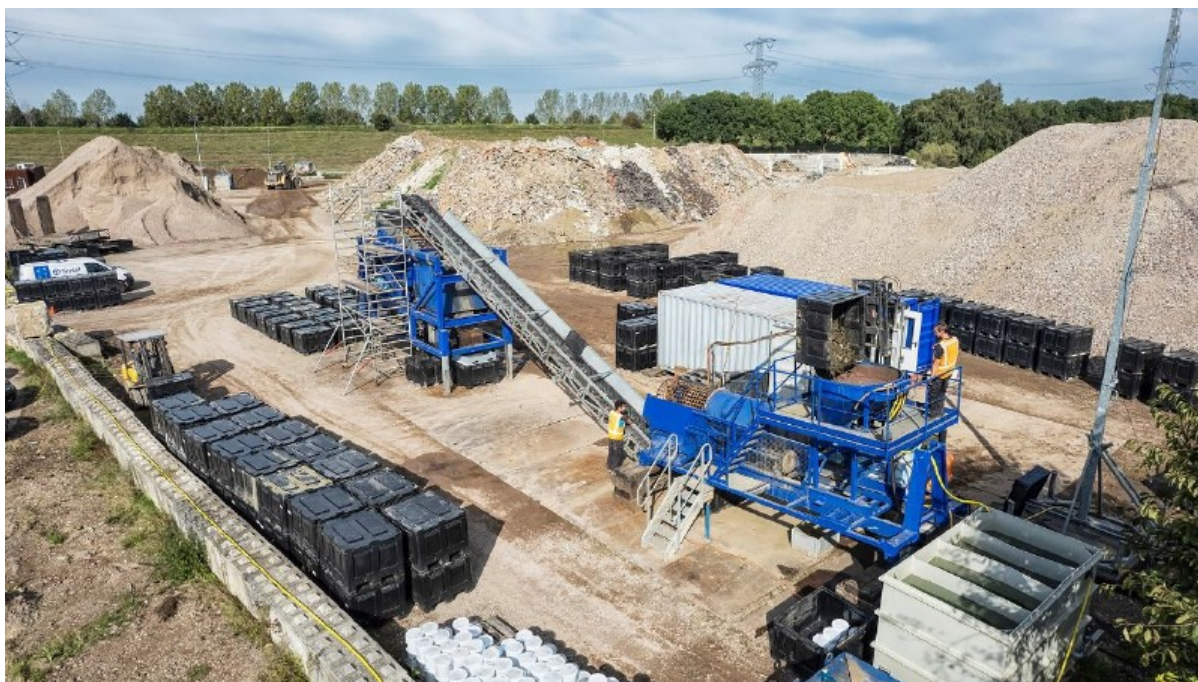
Fig. 4. Zeefinstallatie op de verwerkingslocatie in Echt (BK Ingenieurs, 2023).
